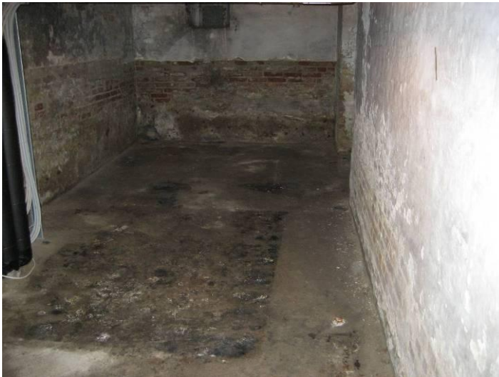
Billede 7. Fugtig kælder med afskallende puds og maling.
