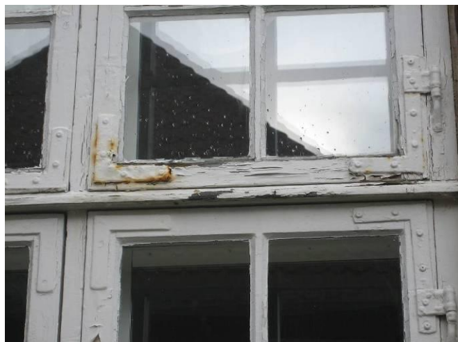
Billede 3. Ældre vindue med afskallende maling og kit samt rust på beslag.
