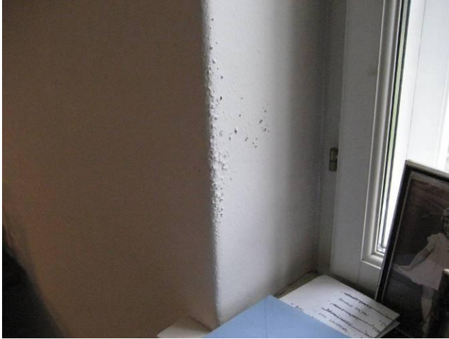
Billede 1. Udbulende tapet ved fugtig facade.
