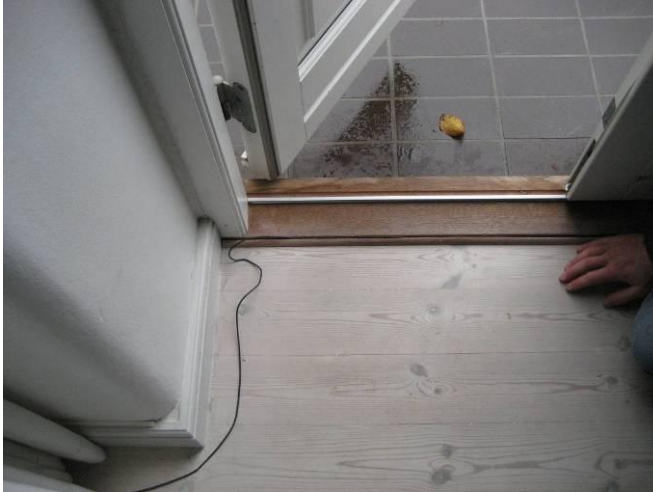
Billede 4. Altandør med kuldebro ved gulv.
