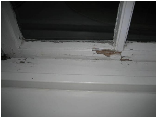
Billede 2. Ældre vindue med afskallende maling indvendigt og stor fuge forneden.
